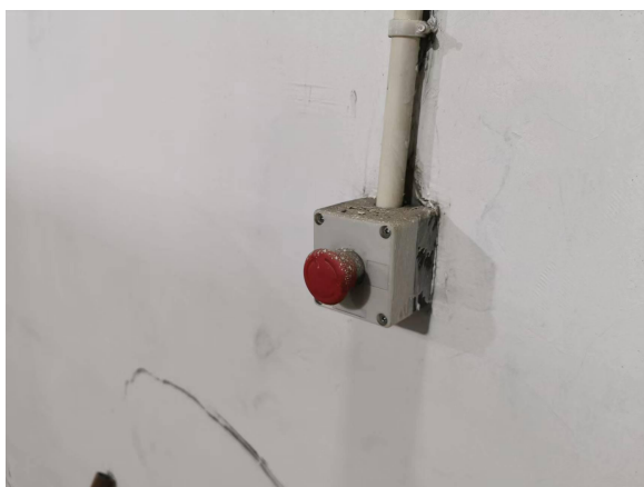
图 4-3 探伤室内紧急停止按钮
