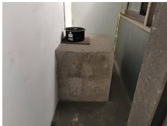
图 4-2 探伤室通风装置
