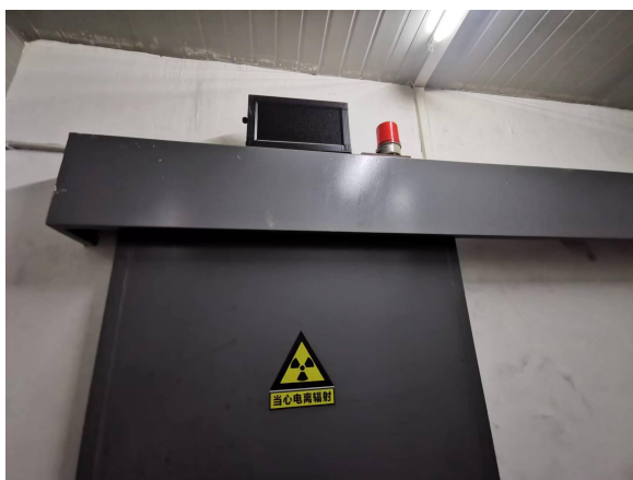
图 4-7 人员进出门防护门辐射安全警示标志、 状态指示灯、安全警示灯
